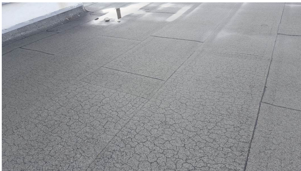
Obr. 5: Bytový dům v Praze. Stav před opravou: původní asfaltová hydroizolace poškozená smršťovacími trhlinami. (Archiv Grey s.r.o.)
