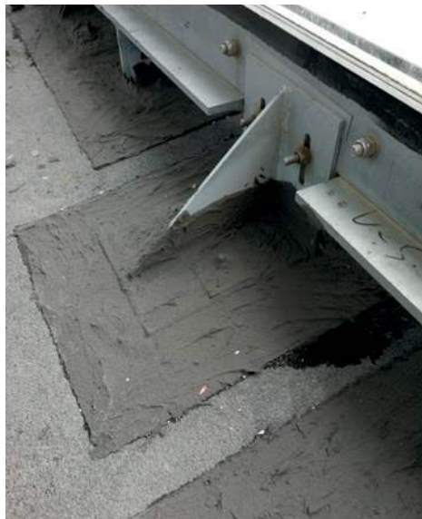
Kotvení ocelového zábradlí skrz hydroizolaci z asfaltových pásů, ProFibre, balkon.
