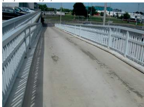
2) Pohled na pojížděnou rampu, stav před sanací
