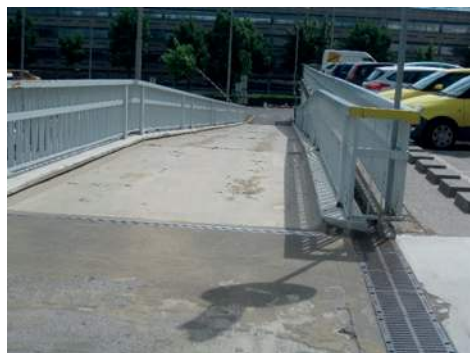
3) Pohled na pojížděnou rampu, stav před sanací
