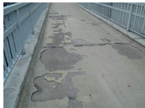
4) Pohled na poškozený povrch pojížděné rampy, stav před sanací
