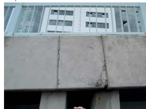
6) Prasklina římsovky – pohled z boku, stav před sanací
