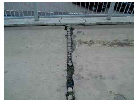
5) Poškození v místě dilatační spáry, praskliny v římsovce – stav před sanací
