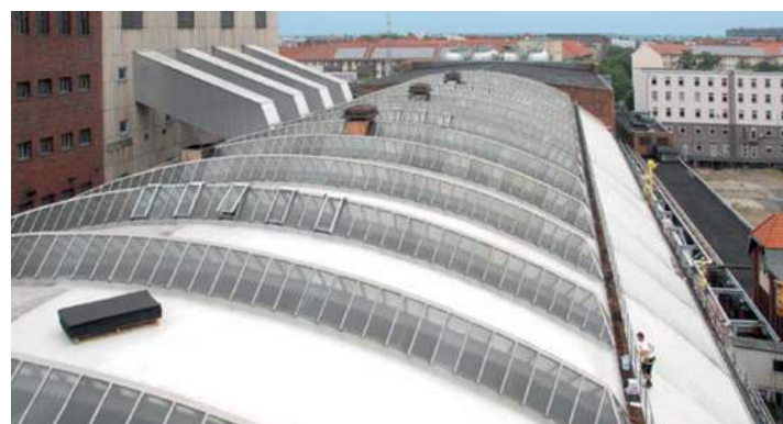
Obr. 4: Střešní konstrukce Maschinenhaus Vattenfall, Berlín, systém ProDetail a ProTect (plocha), uvedení do provozu v roce 2007 (explicitně potvrzena bezvadná funkčnost do současnosti).
