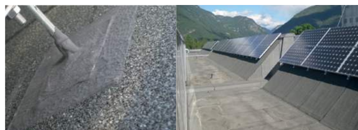
Obr. 5: Prostupy střešním pláštěm pro kotvící prvky solární elektrárny, Wolf Fenster, Bolzano, systém ProDetail, uvedení do provozu v roce 2008.
