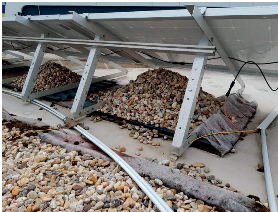
Obr. č. 2. Podložení kovové podpůrné konstrukce fotovoltaických panelů plastovými vlnitými deskami volně položenými na střešní plášti (na geotextilii) a improvizovaná stabilizace panelů kačírkem. Plastové desky nevhodně orientovány kolmo na spád. Podkladní geotextilie je degradovaná, rozpadá se (nevhodné podložení). Riziko sesypání kačírku (nevhodný, nedostačující způsob stabilizace).
